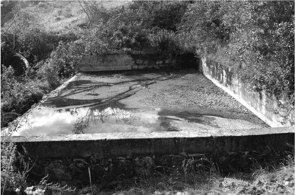
Fig. 17. Reservorio de cemento construido en una quebrada estacional (comunidad campesina Cruz de Mayo, Huaylas, Perú) roto por la presión de las avenidas luego de menos de una década de uso. A diferencia de las quebradas aterrazadas antiguas —cuyos muros de piedra dejan pasar el agua y retienen humedad— los reservorios de cemento son difíciles de reparar
