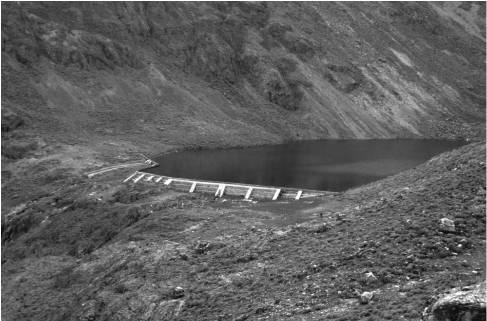
Fig. 19. La presa de concreto de Pacarinancocha, construida sobre las bases de una represa antigua que elevaba el nivel de agua de una laguna de altura, presenta rajaduras preocupantes. Su nombre, “laguna del origen” o “del surgimiento”, sugiere una importancia simbólica de larga data (distrito de Pamparomás, provincia de Huaylas, Perú).
